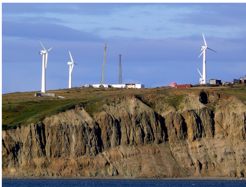
Рисунок 4 – Анадырская ветряная электростанция на мысе Обсервации Анадырского района (2 МВт) 4
