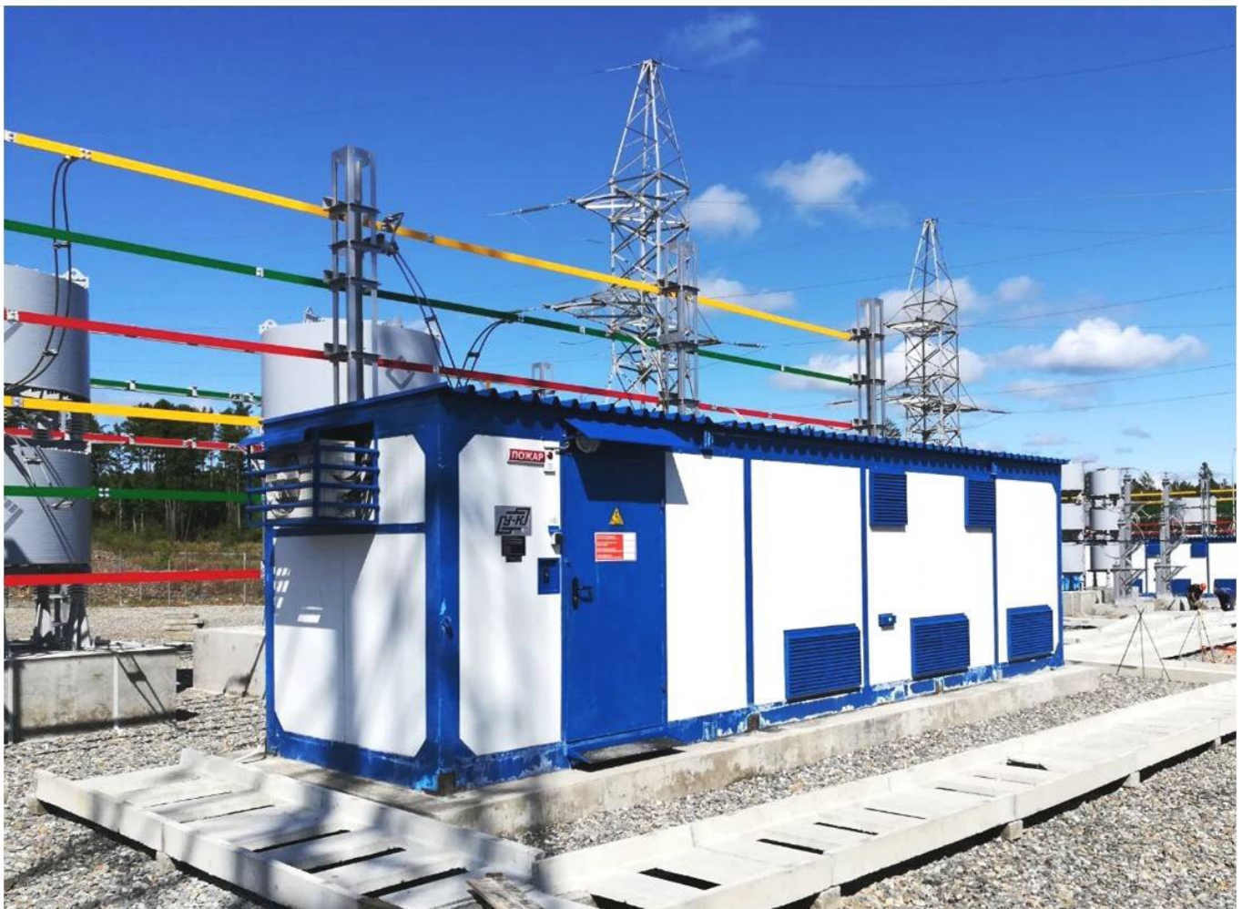
Рисунок 7 – Контейнерное исполнение на примере СТК 35 кВ [14].
